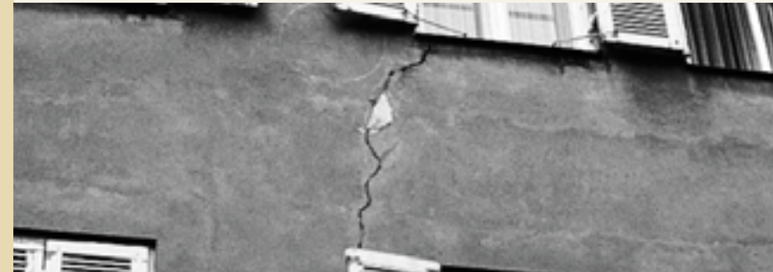
Baudynamische Risse BFS Merkblatt Nr. 19
